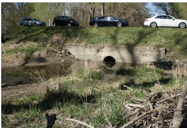
Abb. 57. Rohrdurchlässe begrenzen den Abfluss der Schluten bei höheren Wasserständen. Hier der Rohrdurchlass (DN 1200) unter der Landstraße L549 zur Leimersheimer Fähre.
