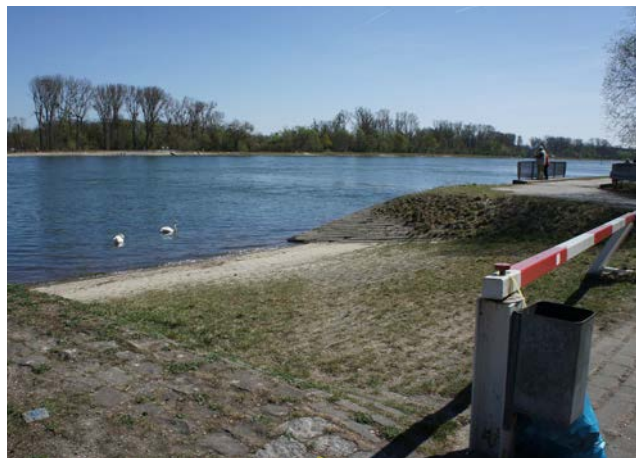
Abb. 34. Im Bereich des Fähranlegers sind drei Rampen vorhanden. Diese ehemalige NATO-Rampe wird derzeit kaum genutzt und kann aus Sicht des Wasser- und Schifffahrtsamtes umgestaltet werden, sofern die Gewässerkante entsprechend den Anforderungen von Hochwasserschutz und Schifffahrt befestigt wird
