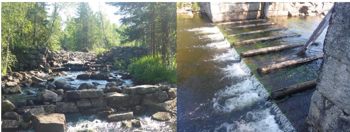
Figur 6. Vänster, raserad kilstenmur sträcka 101. Höger, damm vid sträcka 103
