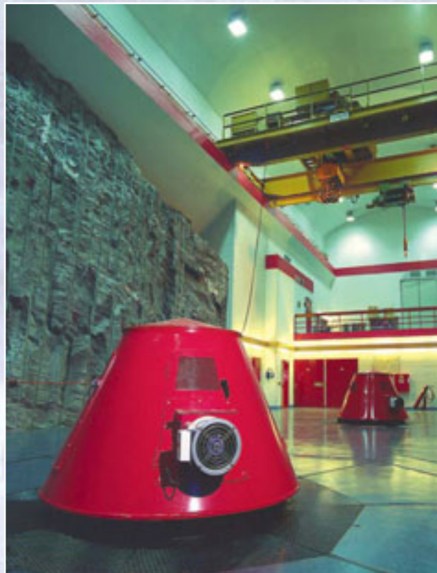
Bildet er fra Lomi Kraftverk som sto ferdig i 1979
