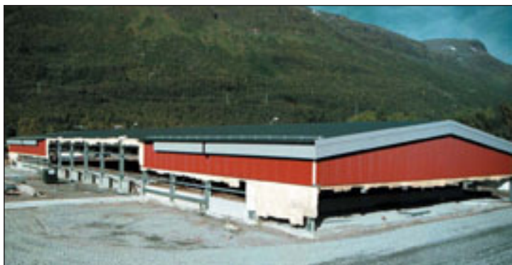
TAR FORM: Kjell Hansen Shippings nye terminalbygg på Sletta i Bjerkvik begynner ta form, og i november antas det at det er full drift ved anlegget.
