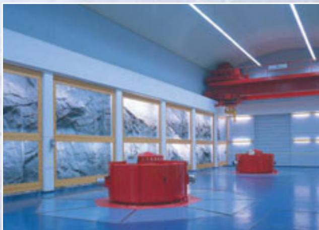
Bildet er fra Sjønstå Kraftverk som sto ferdig i 1984
