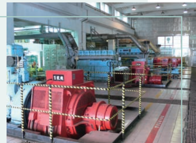
▲ 台電公司蘭嶼發電廠的柴油發電機組。
