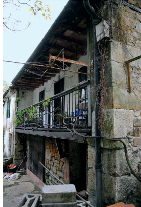
Casas adosadas en Santa Ana, muy deterioradas
