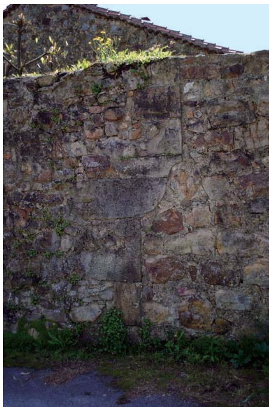
Una ménsula y otros restos incrustados en la cerca
