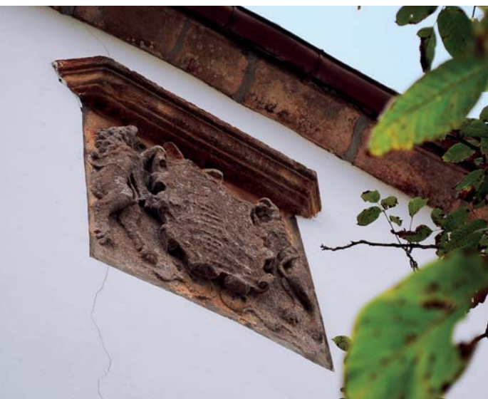
Escudo muy deteriorado
