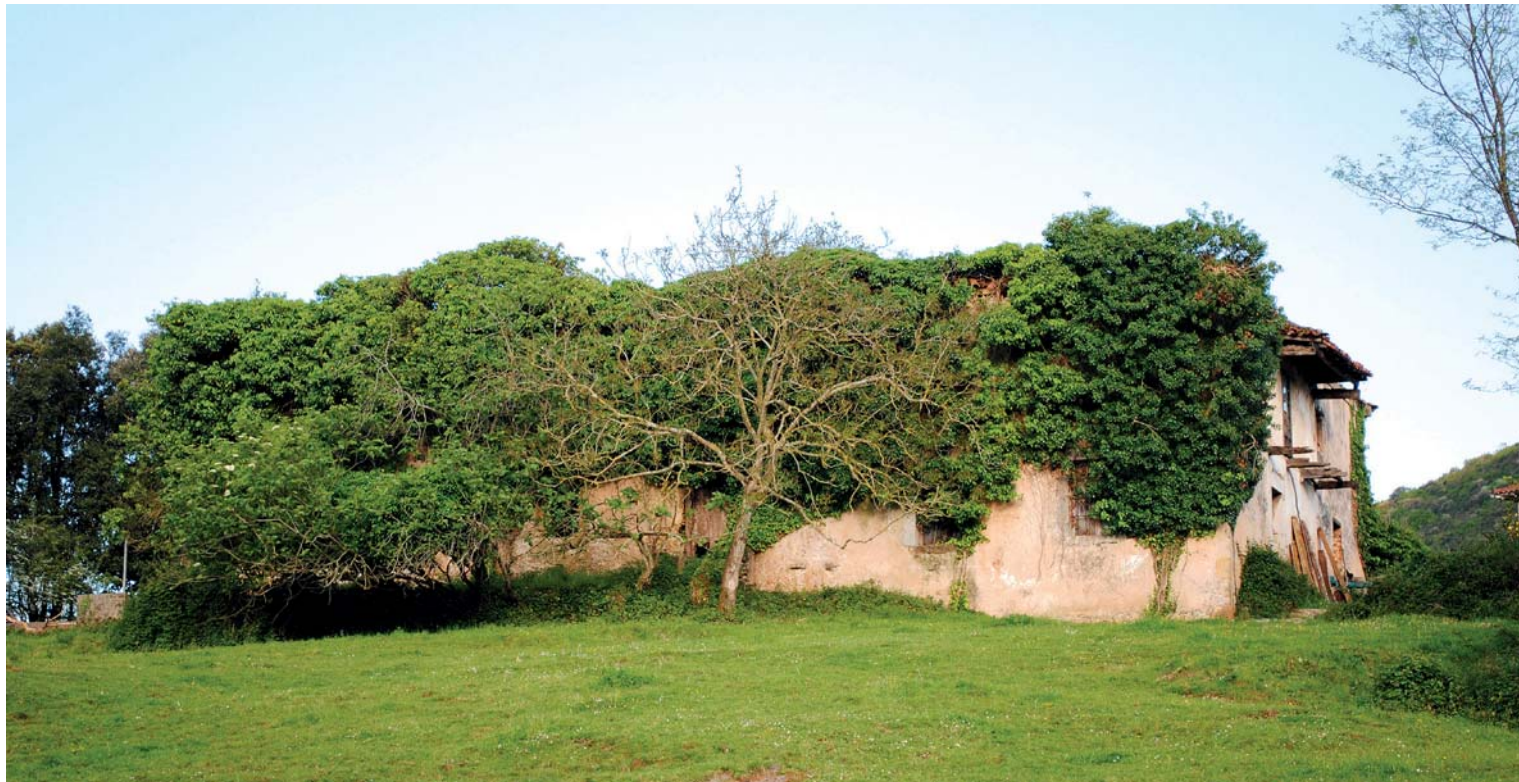
Vista general del edificio en ruinas
