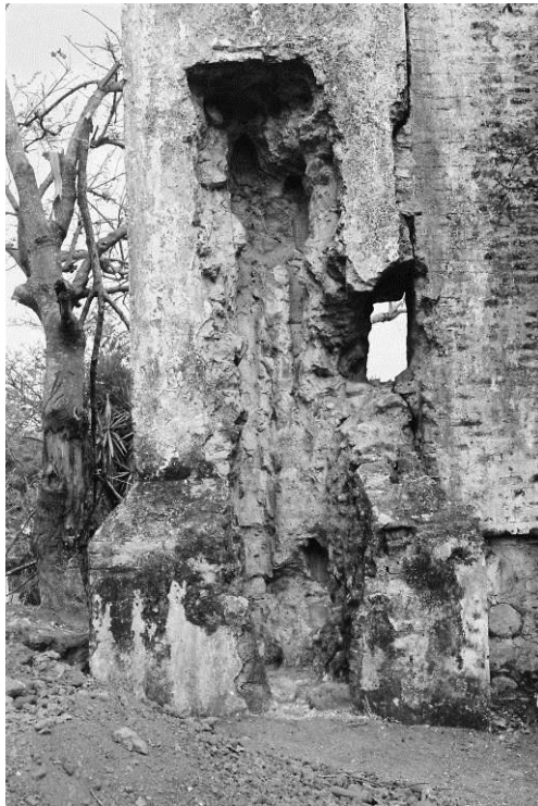
Figura 10. Vista General de los daños de la Segunda Caja de Agua del Acueducto de Esquipulas, Chiquimula (Foto Wolley 2005).
