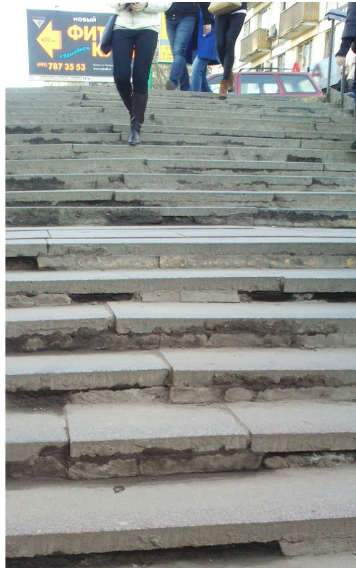
Фото 9. Деформированные ступени с выступами на стыках плит на ст. Дмитровская.
