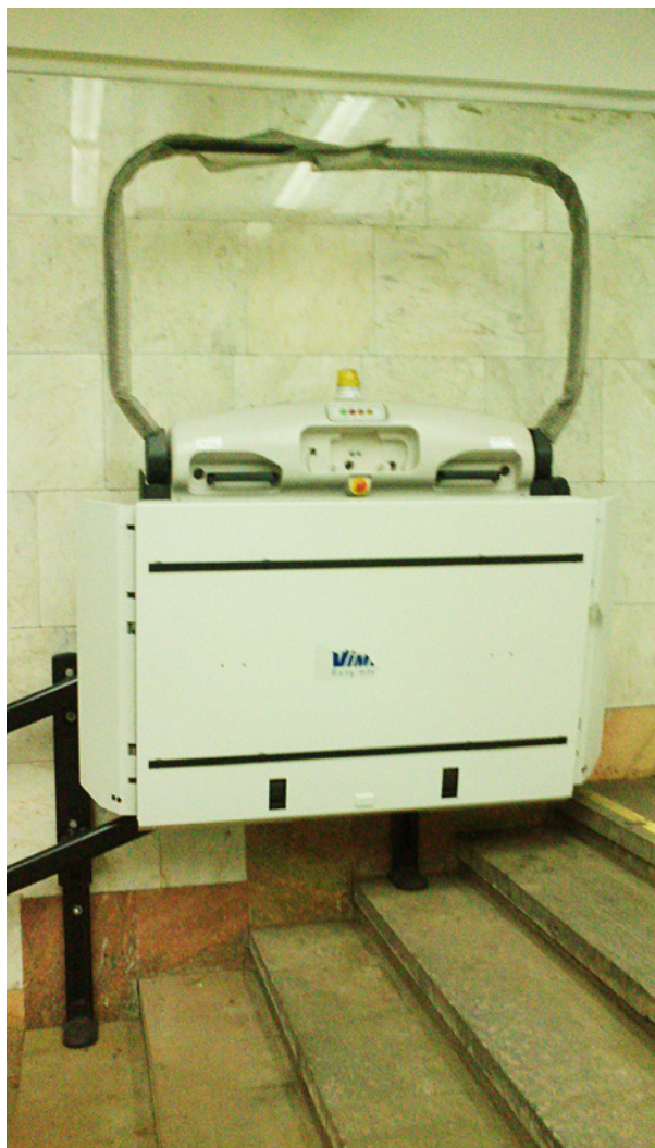
Фото 33. Подъемная платформа с наклонным перемещением на переходе ст. Новосеневская — Битцевский парк спуща 3 месяца после установки до сих пор не введена в эксплуатацию, воспользоваться ею пассажиры не могут ни самостоятельно, ни с помощью сотрудников станции.
