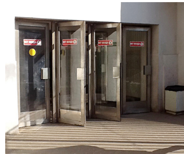
Фото 31. Открывающиеся в обе стороны двери без фиксаторов на ст. Октябрьская.
