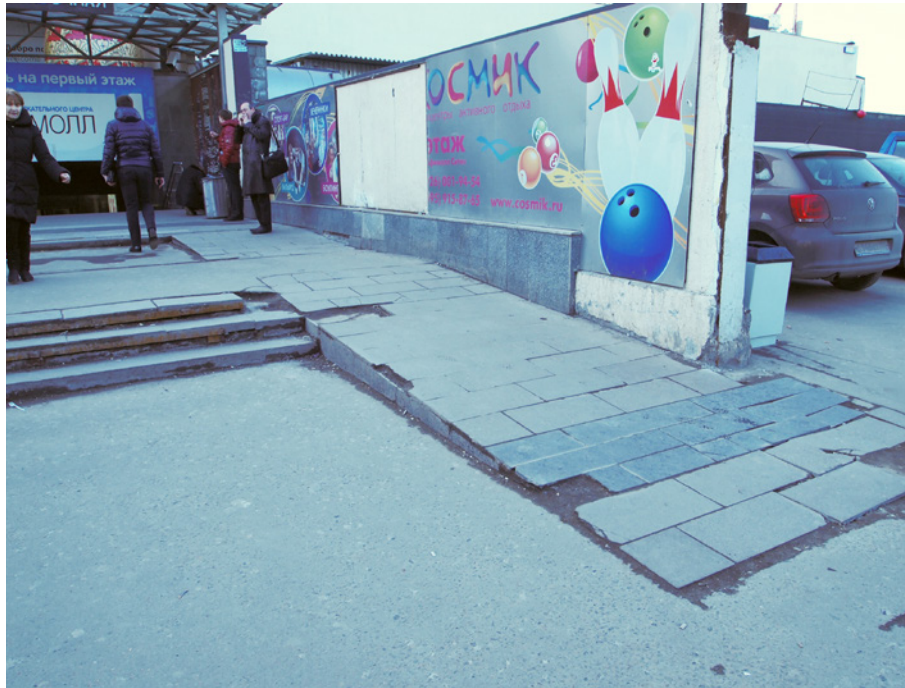
Фото 11. Пандус с дефектами покрытия у входа на ст. Выставочная.
