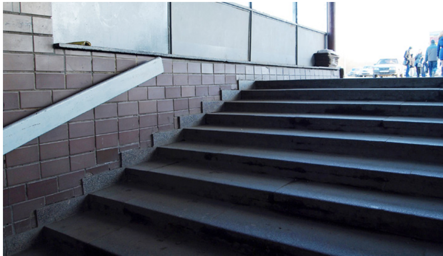
Фото 7. Частично оборудованная перилами лестница на ст. Тимирязевская.
