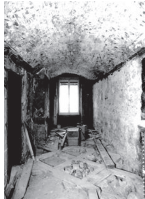
2. Stock, Aareseite, Kabinett. Nussbaumtäfer und -parkett wurden ausgebaut. Rechts die Brandmauer zu Haus Junkerngasse 41, 15./16. Jahrhundert; das Gewölbe wurde im 17. Jahrhundert eingezogen; die Diagonalbalkenlage dient als Unterkonstruktion für die Tafeln des Parkettbodens. (Vergleiche Foto Seite 29, nach dem Wiedereinbau der Täfer).
