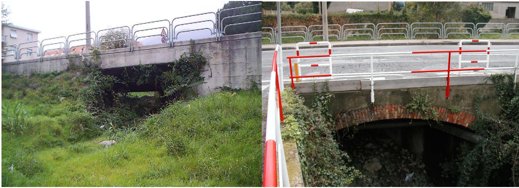
Attraversamento di Via Piave alla confluenza con il T.Segno, con sezione di valle rettilinea (sez 1.2) e sezione a monte ad arco (sez 2)
