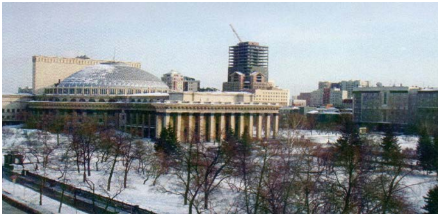
Рис. 2. Строящееся 22-этажное административное здание в многофункциональном комплексе по ул. Депутатской (пл. Ленина) в Новосибирске
