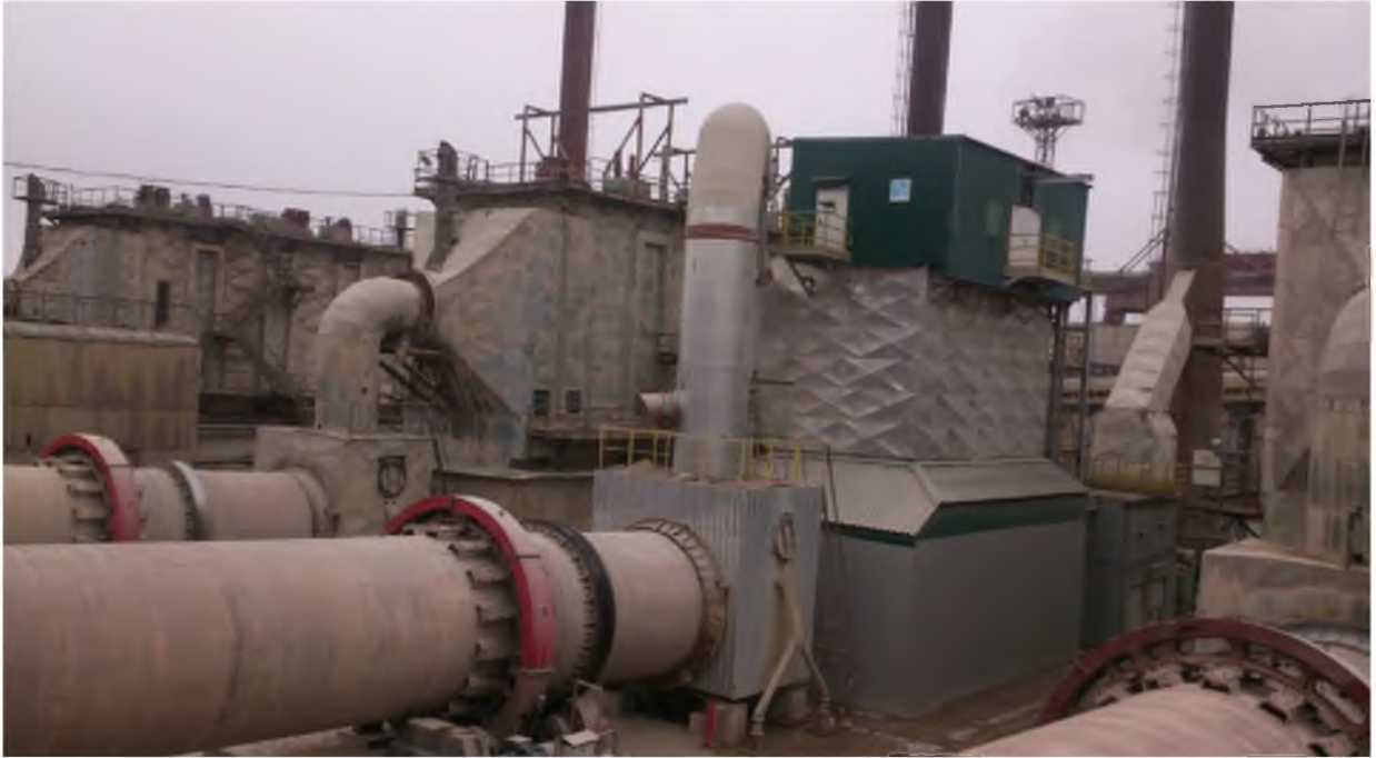
Фото 6.2. ПАТ “ХайделбергЦемент Україна”. Сучасні очисні споруди для сушильного барабану № 2 з ефективністю очистки 99,9 %
