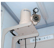
変電所監視カメラ
