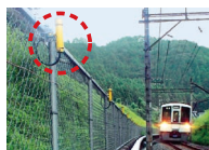
土砂崩壊検知装置
