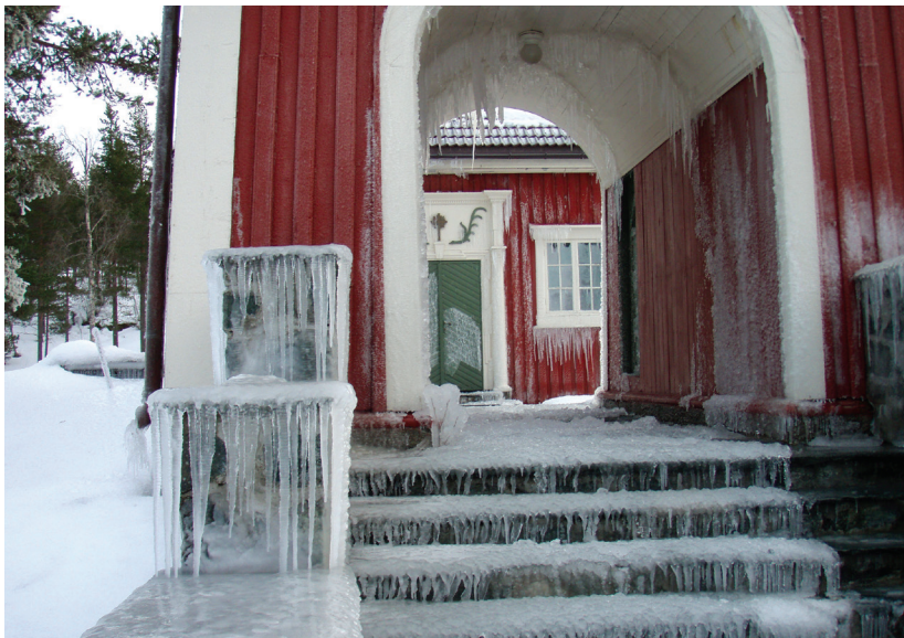
Løkken kapell. Vannskade i forbindelse med lekkasje på sprinkelanlegg.
