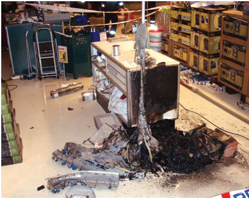
Brannskadet elektrisk utstyr. Dette kan ofte sanneres selv med store skader.
