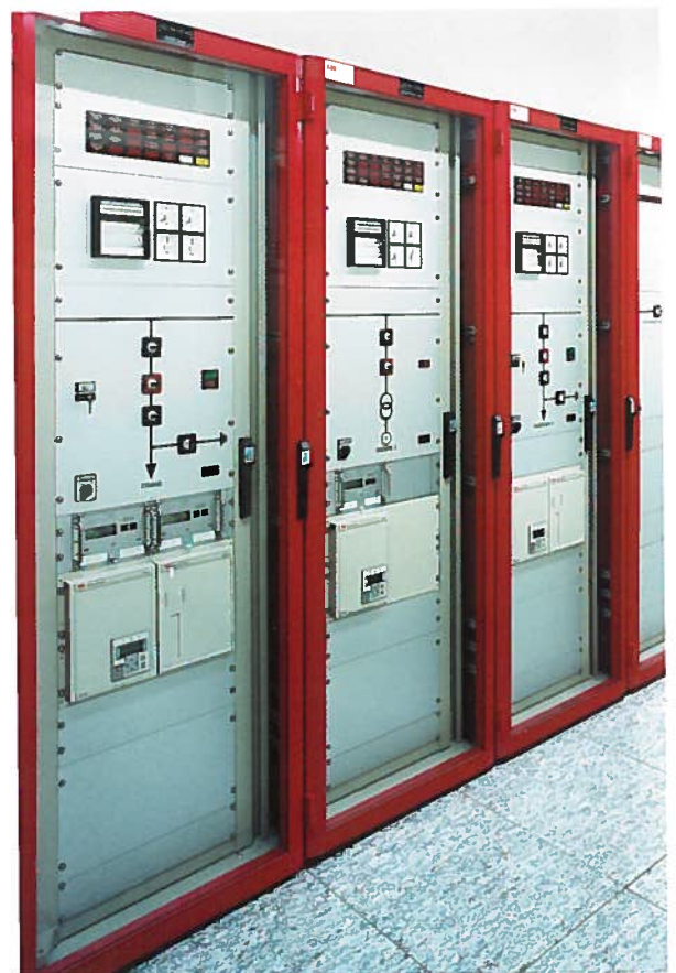
Armoires de commande
