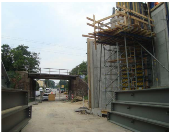
Abbildung 7 Hilfsbrücke und Bau der neuen EÜ Osterburger Straße, Quelle: DB Projektbau GmbH
