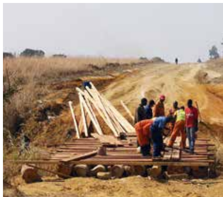
Nebst einer neuen Strasse gibt es nun auch eine frisch erstellte Brücke nach Sambo
