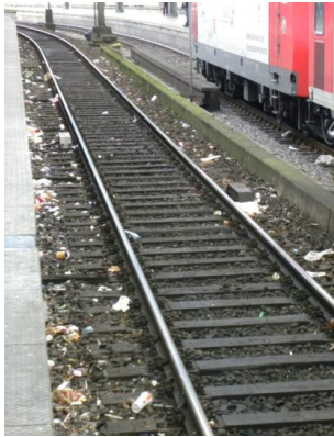
Abb. 20: Verunreinigtes Gleisbett am Kölner Hbf
