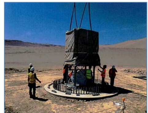
Unidades de Potencia en la zona de obra
