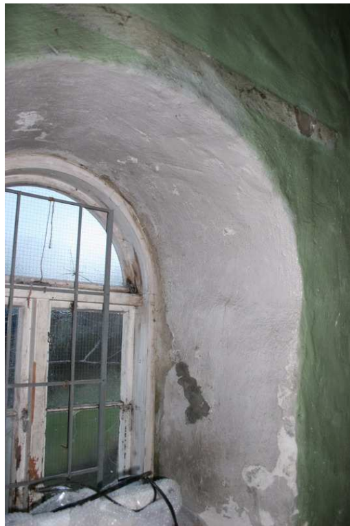
Buet vindu i grunnmur, vaktmesterbolig
