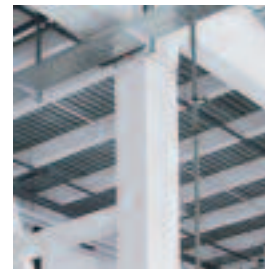
Abb. 14: Fabrikhalle in Dietikon mit Brandschutzverkleidung (Rigips AG)
