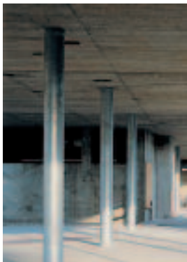
Abb. 22: Brandschutzstützen (Tuchschmid-Atlant) in einer Tiefgarage
