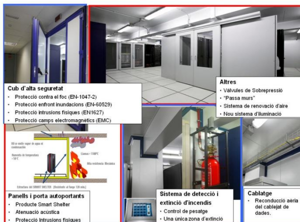
Figura 21. La Sala de Màquines d'alta seguretat
