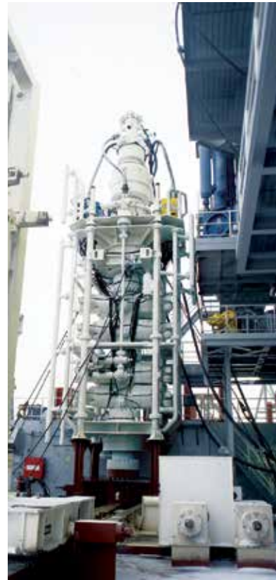
BOP-purkauksen- estoventtiili 1980-luvun alkupuolelta.
