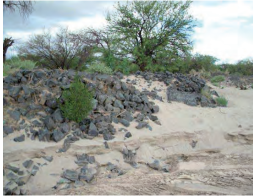
Figura 12. Ingenio Victoria. Barranca del río Santa María, en donde el socavamiento provoca la caída de escorias al lecho.
