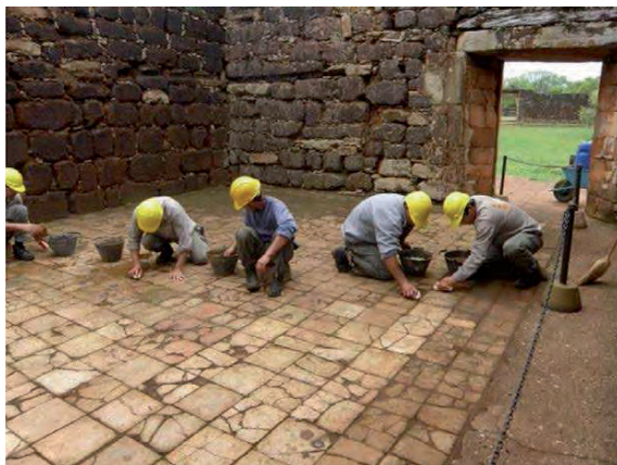
Figuras 14 y 15. Limpieza de pavimentos originales. Fuente: Documentación Obra Puesta en Valor 2009-2010.
