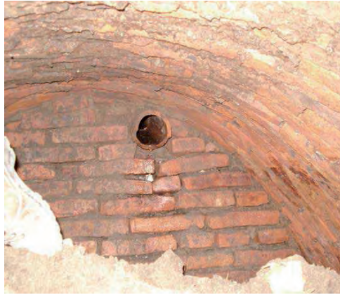
Figura 5. Extremo sur del túnel desemboca en predio lindero, con un caño de barro de desagote.
