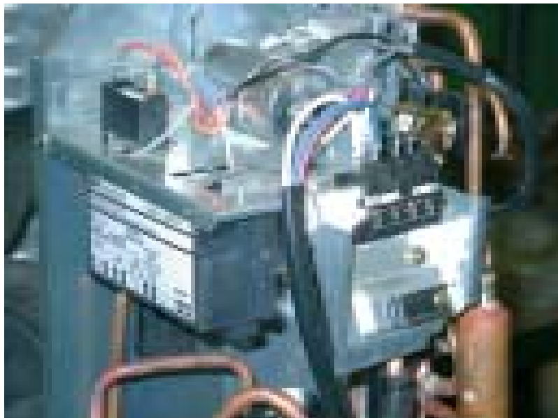
Фото 1. Пример установки регулятора
