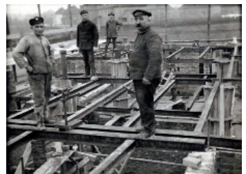
Rohbau der Villa Liebig um 1927, zu erkennen sind Stahlträger der Deckenkonstruktion sowie die Schalungen der Stahlbetonsäulen.
