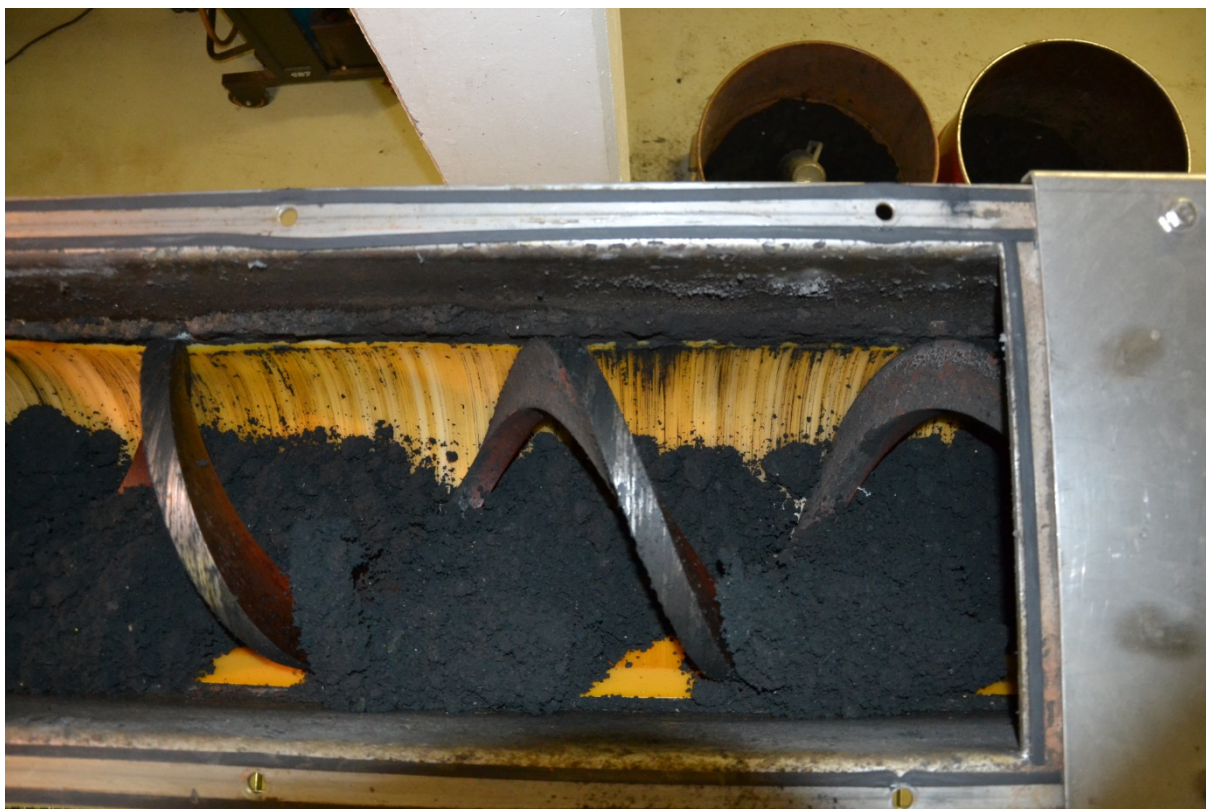
Abbildung 42: Förderschnecke für den Transport von Klärschlamm (zusammen mit HTC-Kohle) in den Ofen der SVA Winterthur (Kläusli, 2013)
