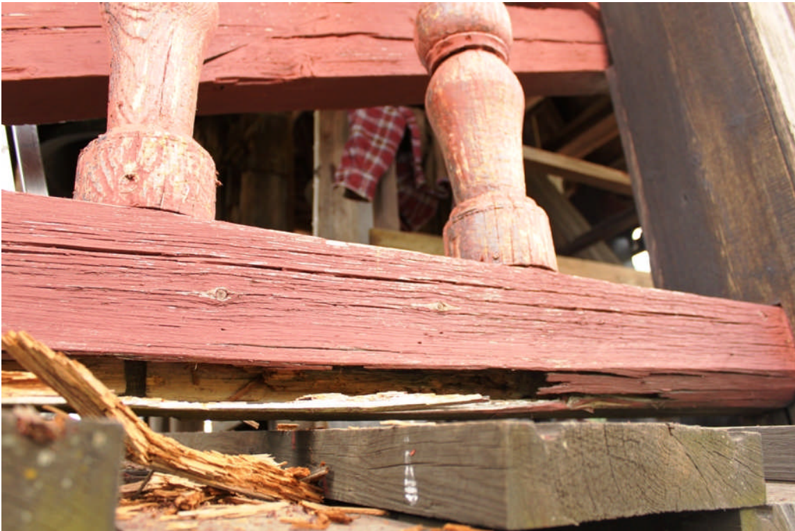
Nedre bjälke åt vänster var drabbad av röta och byttes ut.
