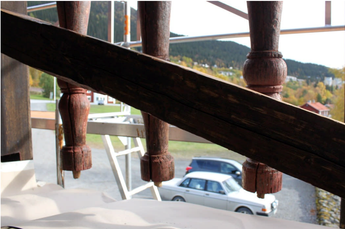
Rötskadad bjälke borttagen, balusterdockornas tappar åt detta håll var kvar men däremot är de avsågade i övre del och enbart fastspikade
