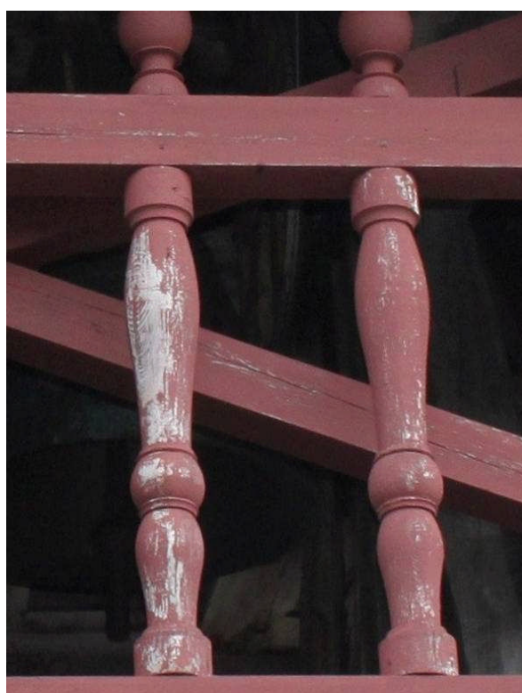
Västra sidan utsätts för väder och vind, färg bortnött
