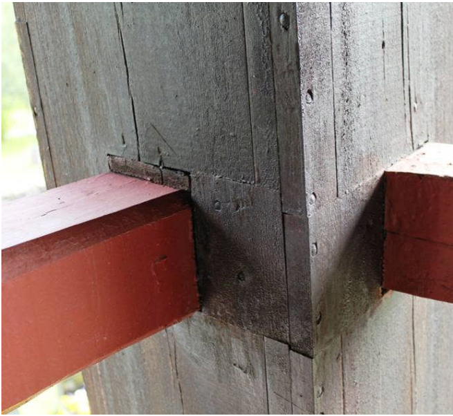
Övre bjälken, hörnet åt söder. Över bjälkens är det kompletterat med extra träbit, fotografiet är taget innan restaureringen
