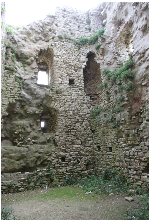
Fig. 6: Interno della torre "Mastra": particolare della copertura a volta a botte dell'ultimo piano.
