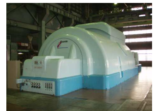
蒸気タービン
