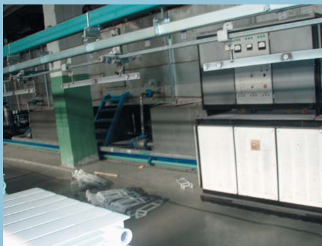
Рис. 3. Общие виды оборудования
