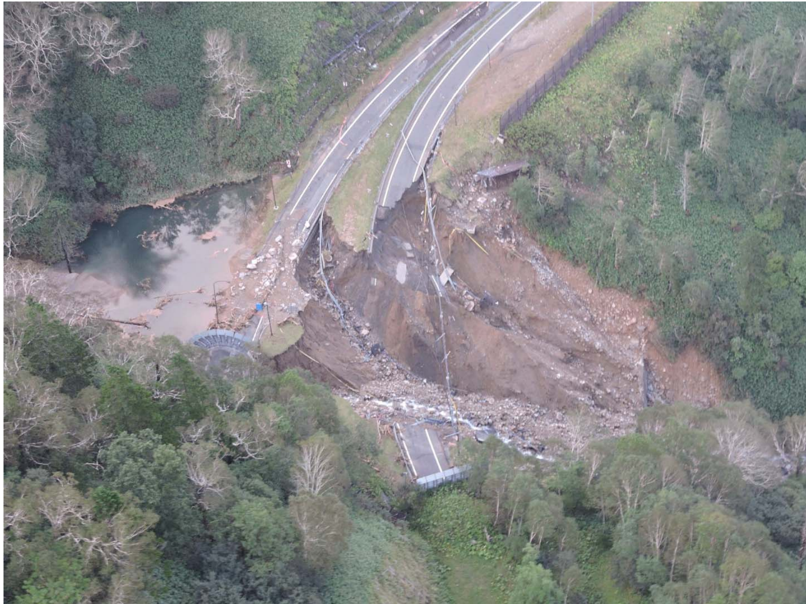
国道274号 清水町 日勝峠8号目付近 (H28.9.1の状況)
