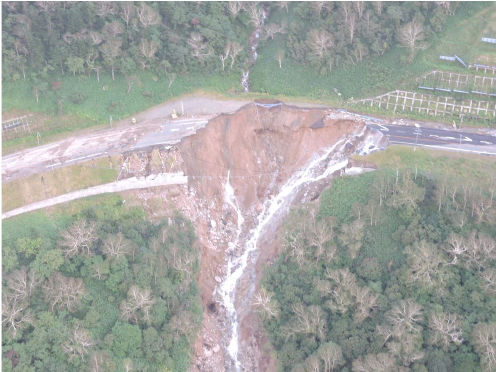
国道274号 清水町 日勝峠7号目付近 (H28.9.1の状況)
