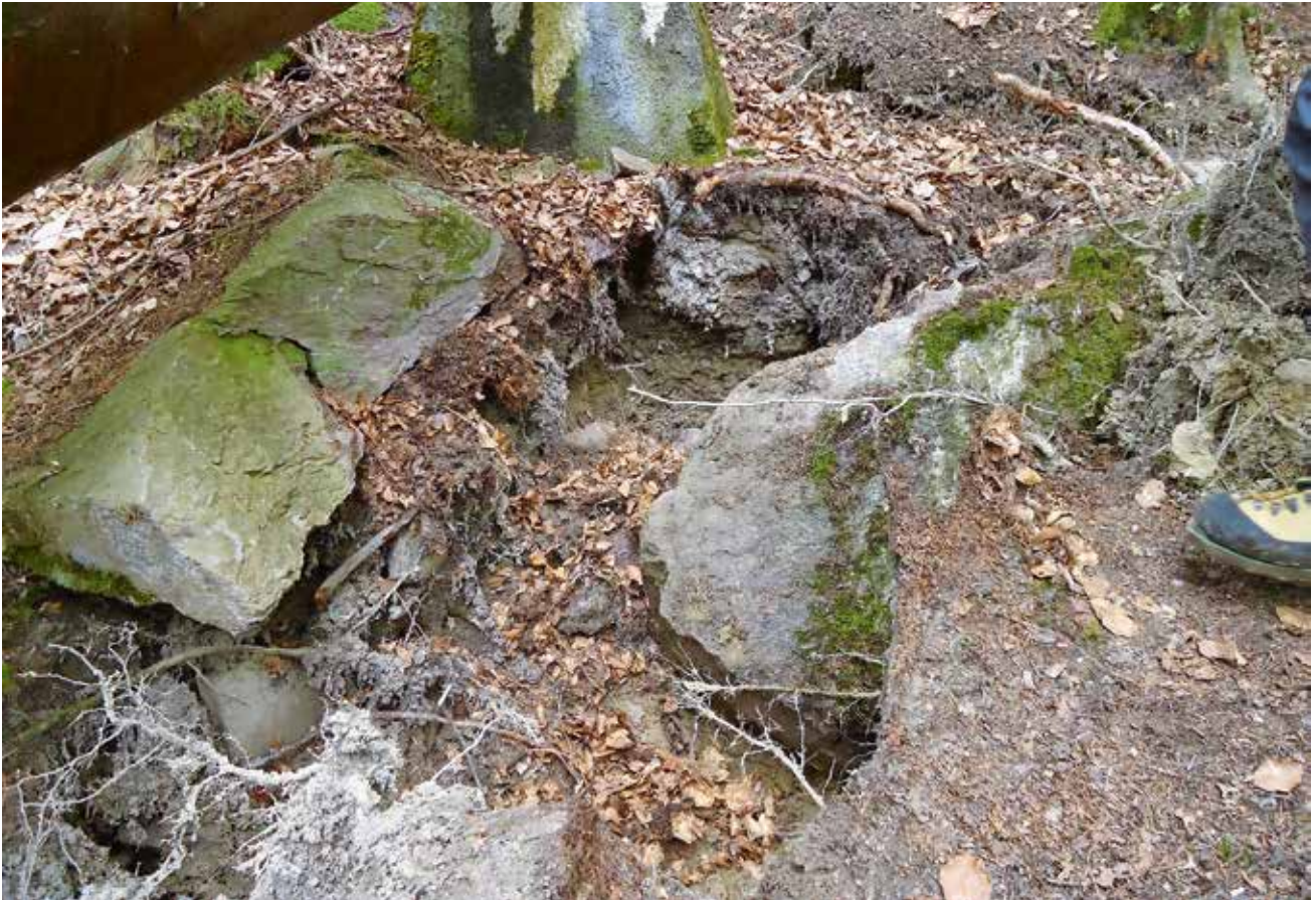
Leitungsstützen drohen bei Erdrutschen abzurutschen.
