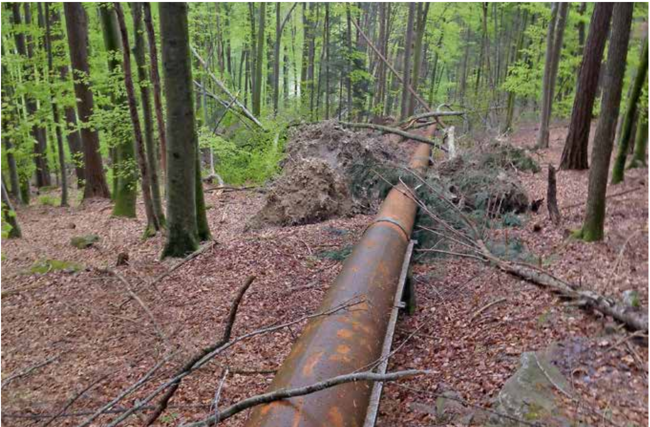
Die Leitung ist der Natur ausgesetzt und die Stahlkorrosion ist nicht mehr zu übersehen.
