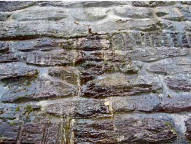
Verschiedene undichte Stellen zeigen, eine Sanierung der Stau-mauern ist zwingend erforderlich.
