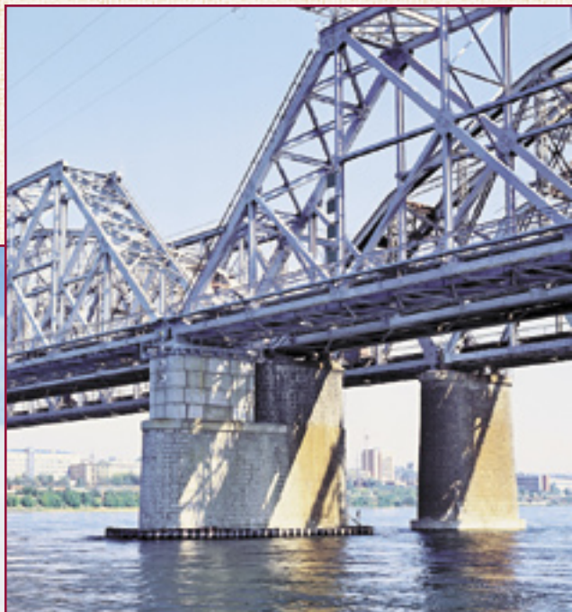
Устройство моста четного пути через реку Енисей в г. Красноярске. Сдан в эксплуатацию в начале 1990-х годов. Описание на стр. 57
