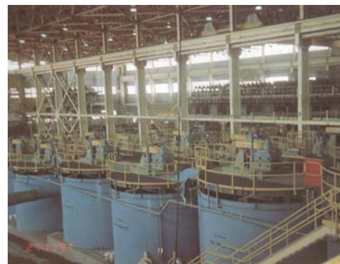
Figura 4.9: Sector de concentración por celdas de flotación
