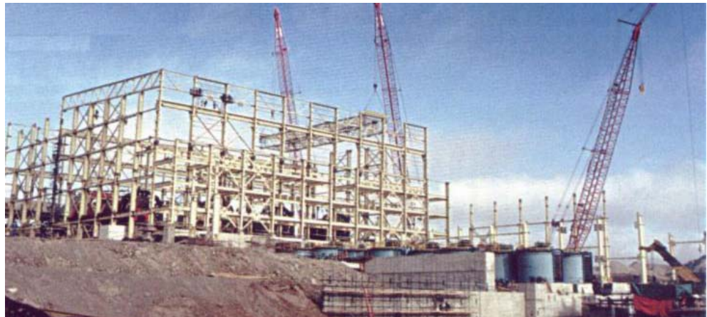
Figura 5.1. Bajo de la Alumbreira. Construcción de la obra civil de la planta de concentración
