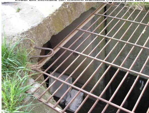
Foto nr. 2B Podet din elemente prefabricate cu inceput de tasare (Municipiul Iasi)
