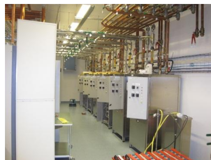
Ett rum fullt av kylanläggningar. Mer-Parten av alla rör är av koppar, både till kylning och till koaxialkablar.
