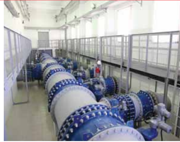
Головний колектор повітрорудної станції
