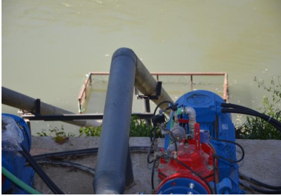
Fotoğraf 10: Pompajlama motorları
