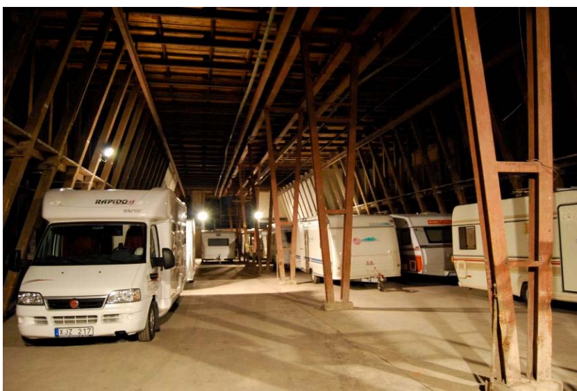
Torkladans inre är en öppen hall. De bärande stålbalkarna är sekundära och tillkom när traverser installerades i byggnaden. 20081209sb-1
