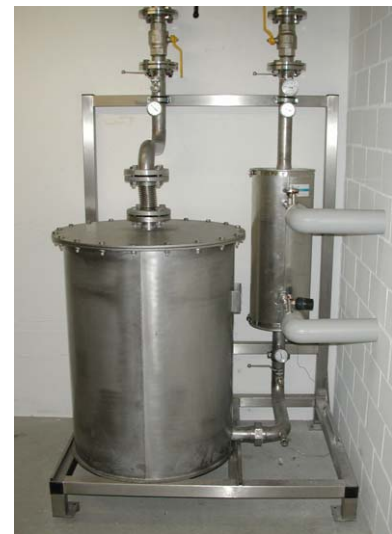
Abbildung 13: Aktivkohlefilter der ARA Pfungen mit Wärmetauscher.
