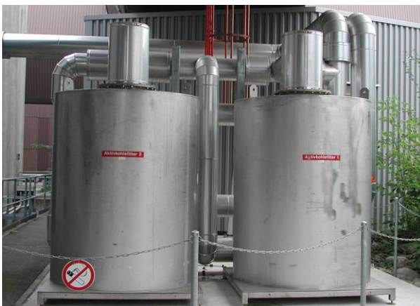
Abbildung 14: Die beiden Aktivkohlefilter der ARA Zürich-Werdhölzli.
