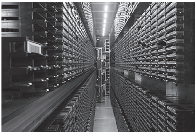
Abb 4 Innenleben eines Storage-Containers; auf den Schienen laufen die Tape-Roboter, die die Bandkassetten zu den Lesegeräten bringen
