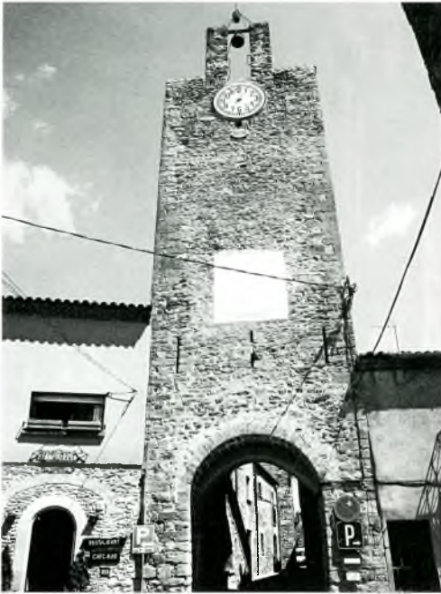
Figura 2: vista general de la façana principal de la Torre de les Hores un cop restaurada, on s'observa la recuperació del rellotge de sol de la façana. Originàriament, n'hi havia un altre d'anterior al damunt, però fou eliminat completament en instal·lar-se l'esfera del rellotge mecànic que es veu a la part superior de la torre, l'any 1936.
