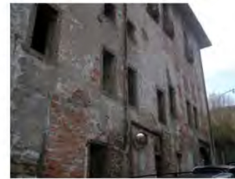
Cono di ripresa n. 10 Intonaco antico, facciata fatiscente dell'unità edilizia n.6
