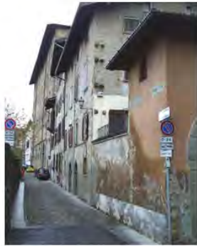
Cono di ripresa n. 1 Intonaci antichi sulle facciate delle unità edilizie n.1 e n.2
