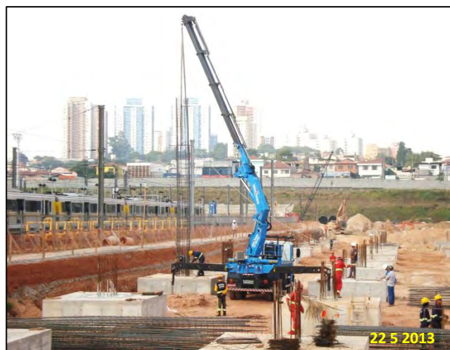
Terminal de Ônibus Vila Sônia: Área do terminal e posicionamento da armação do primeiro pilar
