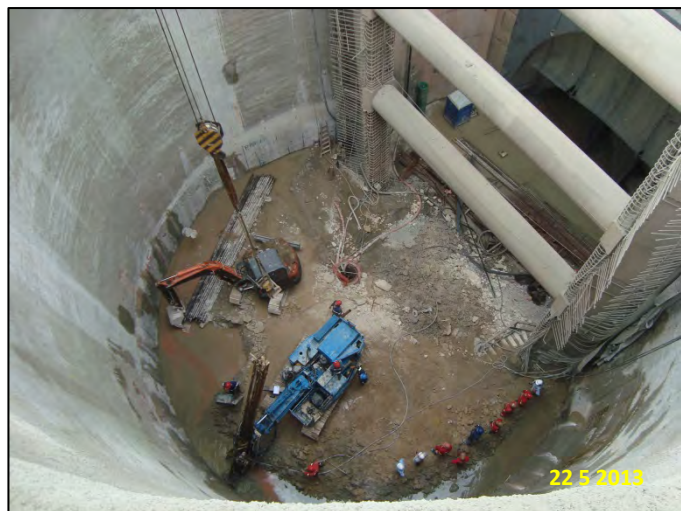
Estação Higienópolis – Acesso Piauí: Sistema de bombeamento de água do lençol freático no Poço P2 e reforço revestimento primário
