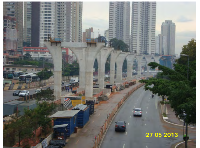
Trecho Brooklin Paulista – Vereador José Diniz: Viga de Protensão concluídas, aguardando lançamento das vigas-guias .
