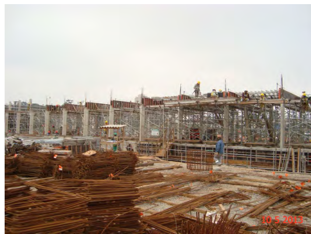
Pátio Oratório: Execução da laje de cobertura do Bloco D1 (Subestação retificadora com GGD).
