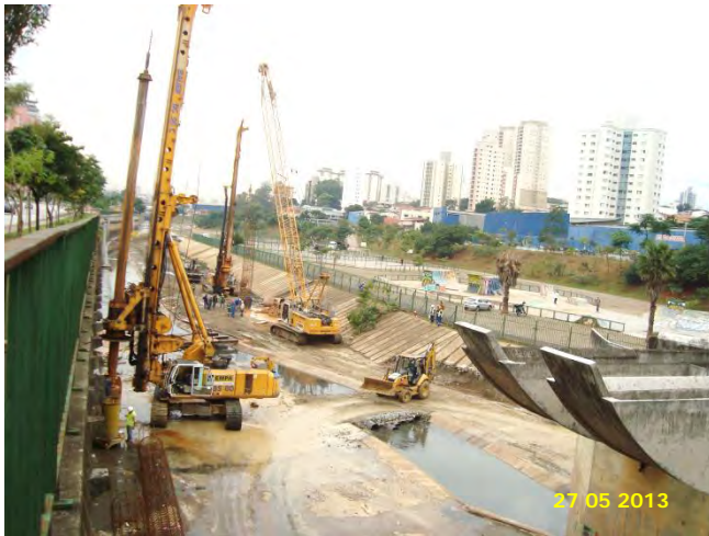
Trecho Vila Paulista – Jardim Aeroporto: Estacas na região do Piscinão em execução.
