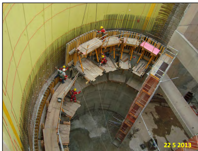
Estação Oscar Freire – Acesso Jardins: Execução da parede do revestimento secundário do Poço P2
