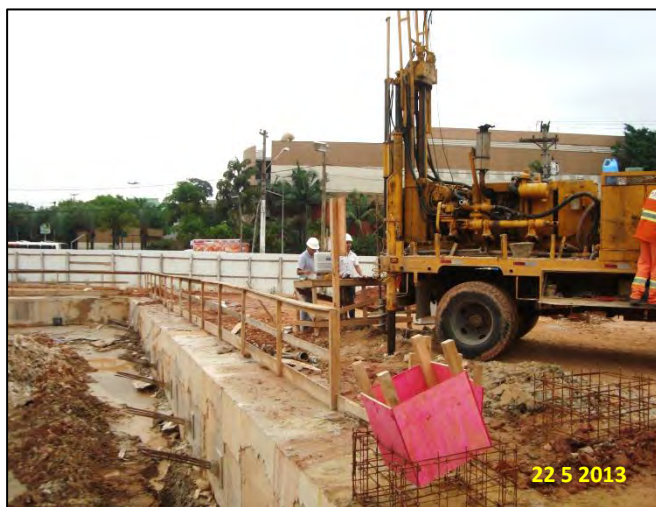
Estação São Paulo-Morumbi – Acesso Norte: Tirantes da parede diafragma protendidos e execução de sondagens
