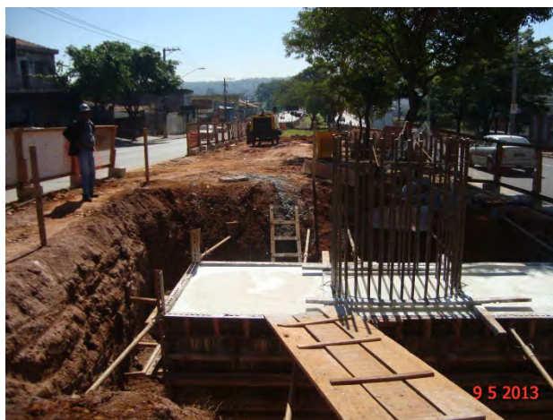
Trecho São Mateus - Iguatemi (Avenida Ragueb Chohfi): Execução dos blocos dos pilares da via.
