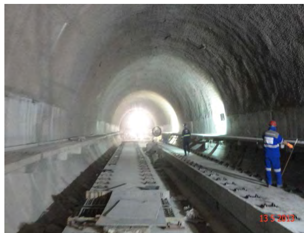
Lote 1 – Túnel – Via Permanente – Adolfo Pinheiro - Conde de Itú: Concluída a laje flutuante da via permanente
