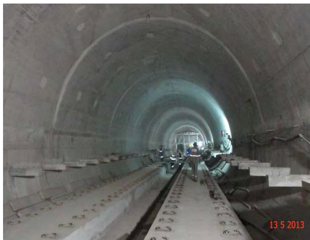
Lote 1 – Túnel - Via Permanente - Largo Treze - Adolfo Pinheiro: Concluída a laje flutuante da via permanente
