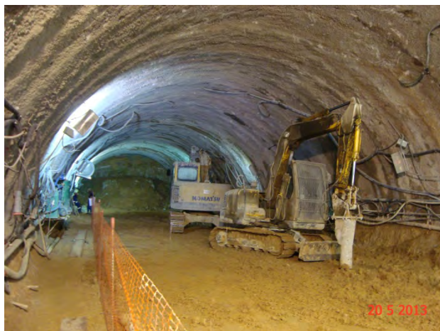
Lote 3 – VSE São Sebastião: Finalizada a escavação da calota do túnel de ligação
