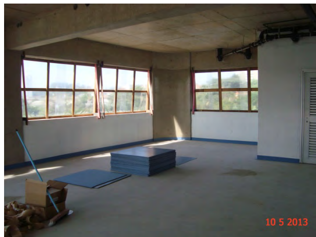
Estação Oratório – Edifício Operacional: Execução do acabamento com a instalação do piso Nora.
