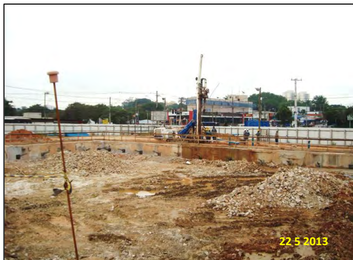
Estação São Paulo-Morumbi – Acesso Norte: Escavação do VCA e execução dos poços de rebaixamento do lençol freático
