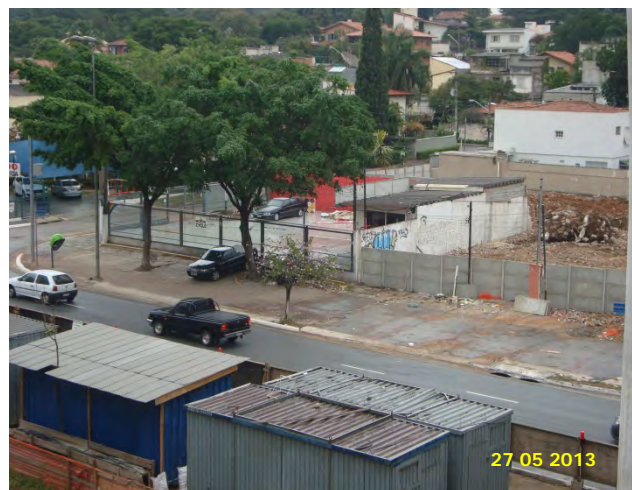
Trecho Vereador José Diniz – Campo Belo: Demolição dos imóveis na região do Acesso da Estação Vereador José Diniz.
