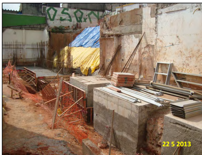
SE David Matarasso: Blocos de fundação e armação da parede do muro de arrimo
