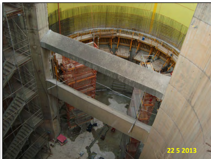
Estação Oscar Freire – Acesso Jardins: Vista geral dos Poços P1 e P2
