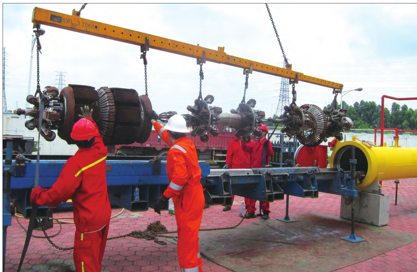
金山分输站至佛山末站管道内检测漏磁检测发球
