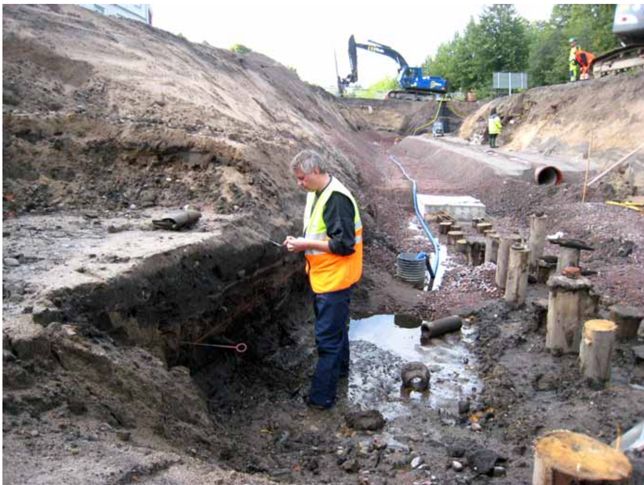
I samband med schaktningsarbeten för VA utfördes i september 2011 en kvartärgeologisk provtagning av Mats Regnell med undersökning av djupt liggande jord- och torvlager i Junebäcksravinen strax SÖ om korsningen Västra Storgatan - Juneleden. Foto fr. N.
