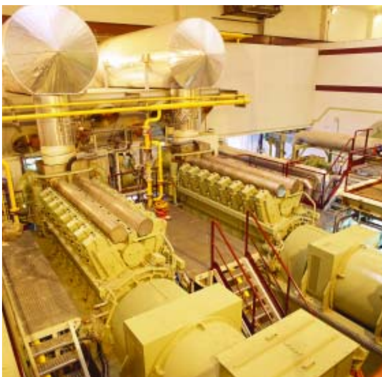
Estación depuradora de aguas residuales de Galindo. Planta de secado de lodos. Vizcaya.
