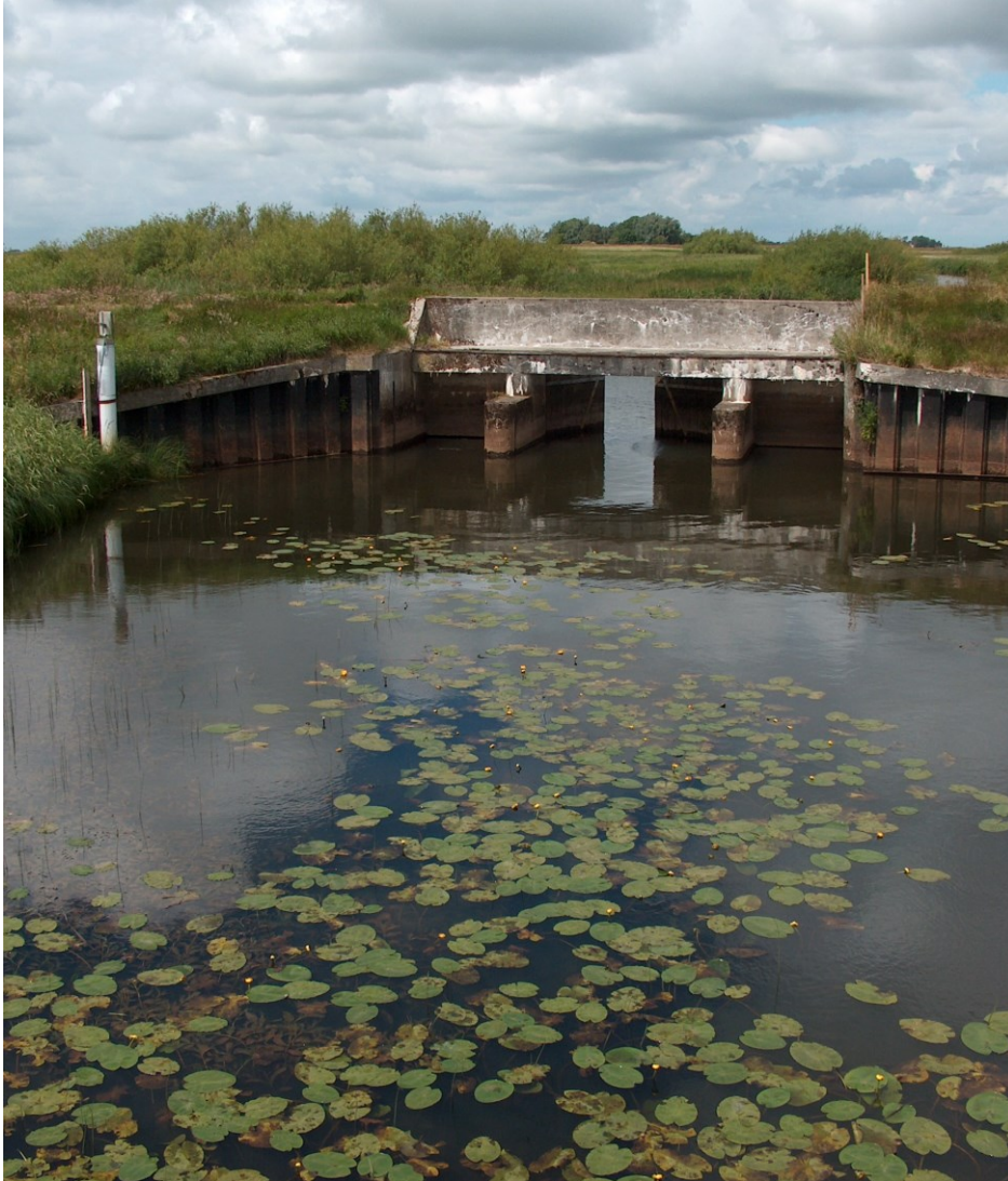
- stemmeværk og højvandssluse i Sønderå opstrøms Magister Kog og Rudbøl sø i Tøndermarsken
