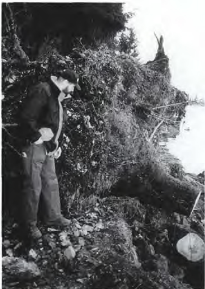
Umgestürzte Bäume haben auch die seeseitige Mauer beschädigt.
