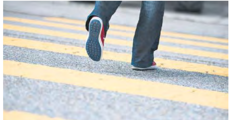
Sanieren oder weg damit. Bisher wurden bei rund einem Drittel der 900 mangelhaften Fussgängerstreifen im Wallis Massnahmen umgesetzt.
